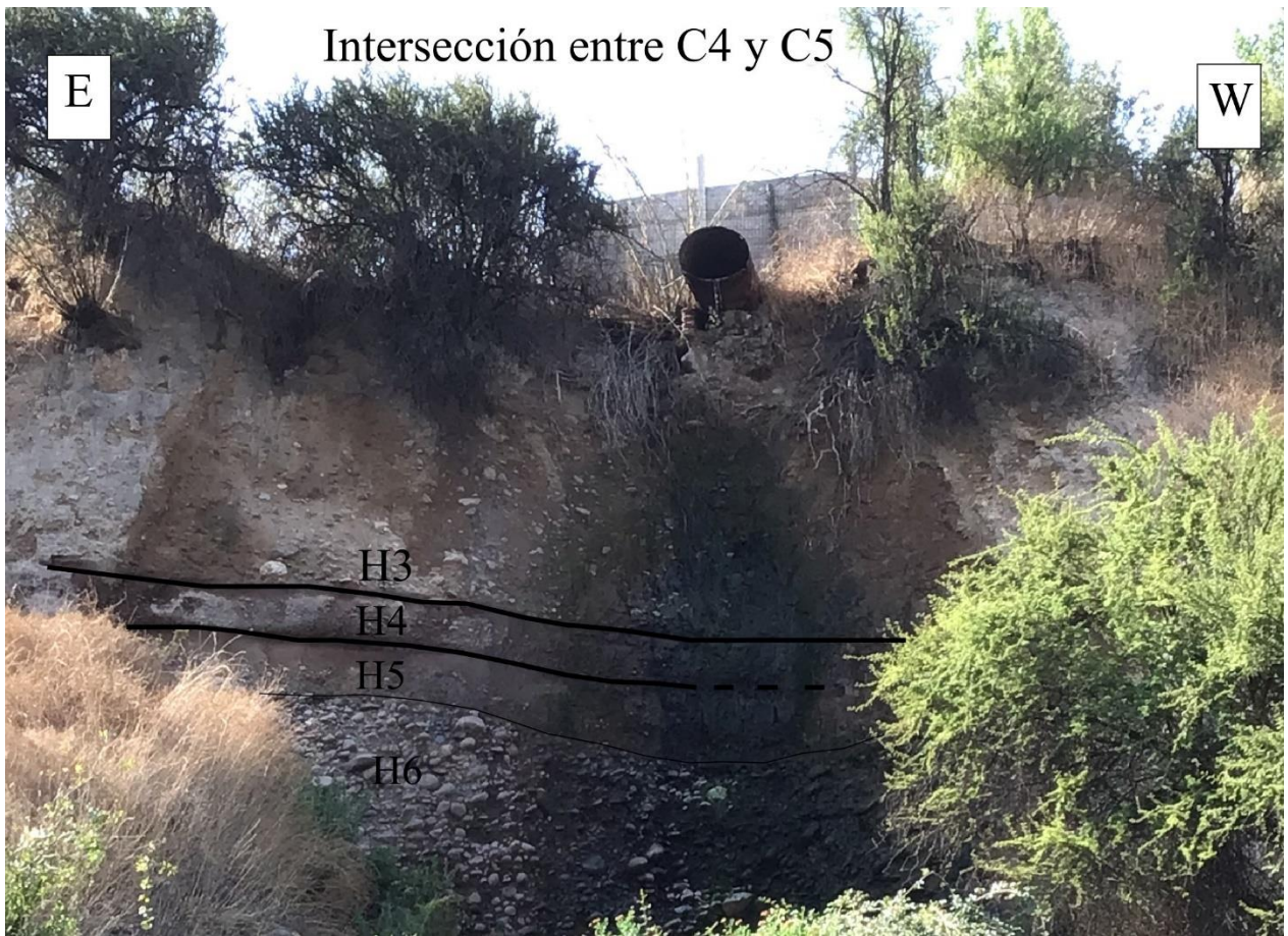
Figura A4: Fotografía de escarpe presente entre la intersección de los cuarteles C4 y C5. Se observa la presencia de los estratos E3, E4, E5 y E6. Escala alrededor de los 15 metros de altura entre base a techo.
